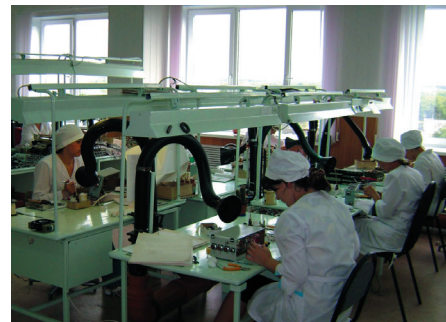
Рис. 2.6. Система вентиляции с использованием ФПЛ и МПВУ «Пластик-75». Монтажный участок, ОАО «Октябрь», г. Тамбов
