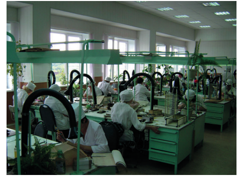
Рис. 3.6. Система вентиляции с использованием ФПЛ и МПВУ «Пластик-75». Монтажный участок, ОАО «Октябрь», г. Тамбов
