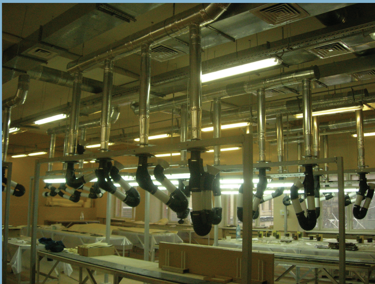
Монтажный участок, оборудованный МПВУ-1,5-100
