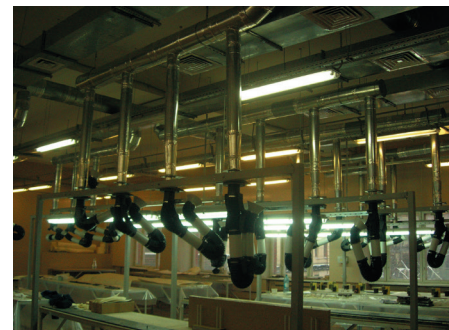
Рис. 3.3. Система вентиляции с использованием МПВУ-1,5-100 (верхнее крепление). Монтажный участок, ФГУП «Алмаз-Антей»
